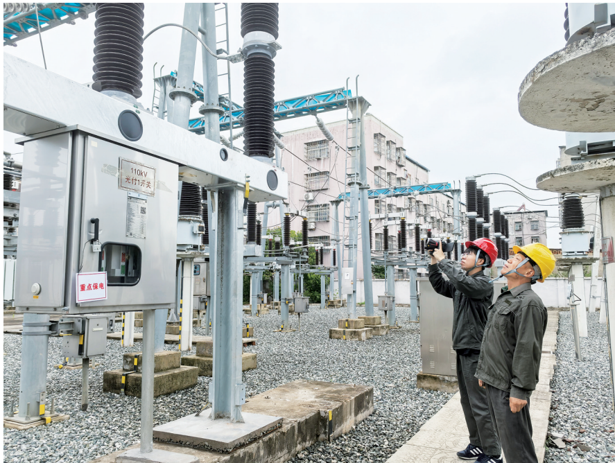
“1号主变压器油位正常,测温无异常。”7月28日正午负荷高峰时段,国网光山县供电公司运维人员对110千伏紫水变电站开展高温专项特巡,排查设备安全隐患,确保电网安全稳定运行和电力可靠供应。
