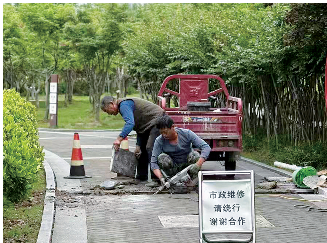
百花园坐落在羊山新区核心地段,是广大市民生活里的一方惬意天地。近日,我市对百花园灌溉管道进行维修、更换,提升绿化精细养护效能,为市民打造更优质的游园环境。图为工人正在对破损灌溉管道进行更换。 本报记者 韩蕾 摄
