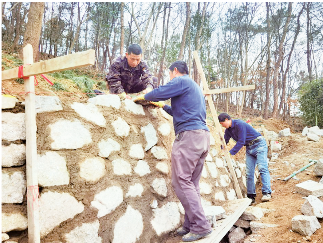
昨日下午,工人们正在贤山公园西门入口处修建设道护坡。目前,贤山公园的建设正在有条不紊地进行,一期工程中的旅游步道已铺砌石板数百米。据了解,贤山公园旅游步道全长6320米,其中山脊主路长3700米。贤山公园的建设,将为市民提供又一处健身、休闲、享受“森林氧吧”的佳地。
