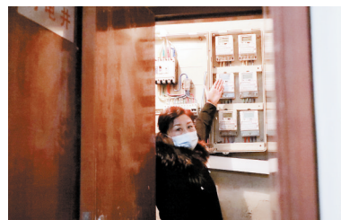
浉河区水岸东方小区新安装的电表 本版摄影:李凯 周亚涛 王安珂
