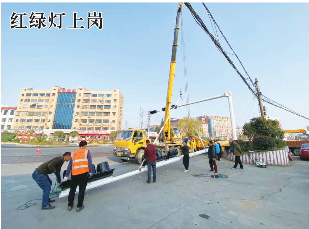
近日,在鸡公山大街与民权南街交叉口红绿灯建设现场,施工人员正在拼接信号灯管道。该路口红绿灯的完善,将有效降低事故发生率,缓解了该路段的出行压力,也有效保障了市民的出行安全。
