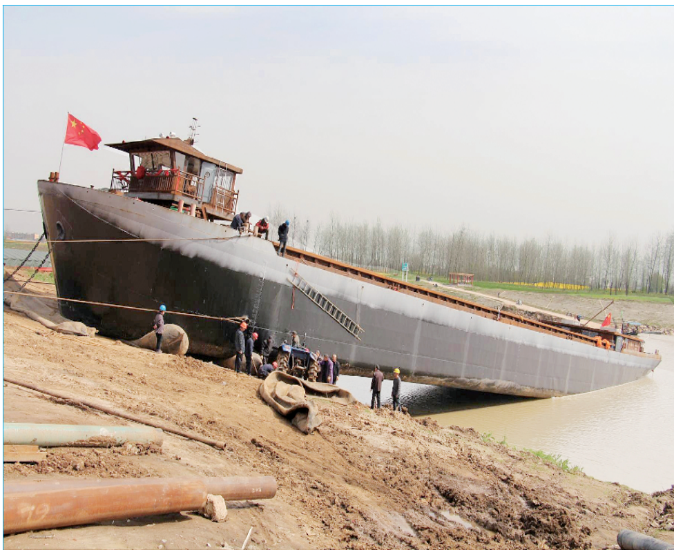
3月22日,淮滨县造船园区,各船厂造船平台全部开工,工人们都在热火朝天地忙碌着,场景十分壮观喜人。图为造船园区内的生产场景。
