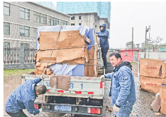
近日,信阳供电公司变电运维中心组织人员冒雪为新成立的县域运维班配发安全工器具柜,切实保障变电站安全设施齐全。 方菲 摄
