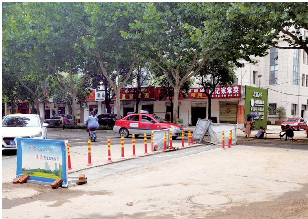
22日上午,谿堂社区路口处南湖路两侧的污水管道正式接通,该路口持续数月的窨井往路面翻水的状况终于得到治理。据现场施工人员介绍,南湖路南北两侧的管道已全部对接完成。若天气允许,施工留下的坑道会在三四天内填补上沥青。 本报记者 张方志 摄
