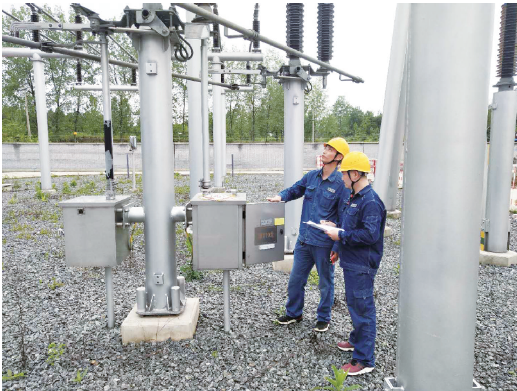
6月17日,信阳供电公司变电运维中心运维值班员冒着闷热难耐的“桑拿天”,在固始县境的220千伏漳圣变电站操作设备,为新投变压器做好试运前准备,备战夏季用电高峰。 方菲 摄
