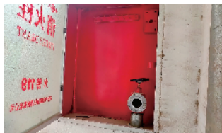
小区内的消防栓无软管更无水 本报记者 张方志 摄
