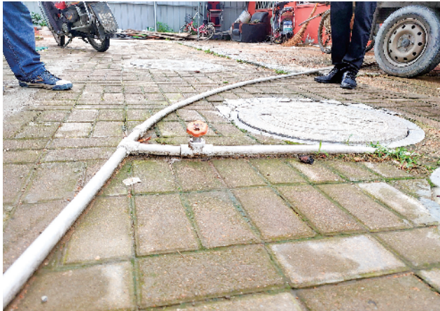
裸露在地表上的供水细管 本报记者 张方志 摄
