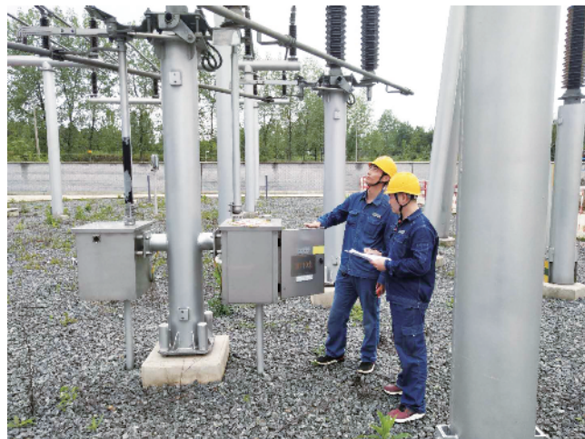
6月15日,信阳供电公司变电运维中心运维值班员冒着闷热天气,在固始县境内的220千伏津圣变电站操作设备,为新投变压器做好试运前准备,备战夏季用电高峰。 方菲 摄
