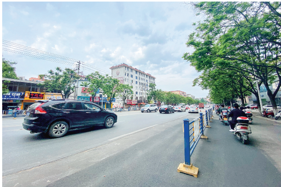
近日,南京大道道路污水管网新建工程完成主管网铺设。半幅封闭近1月的道路交通恢复正常。目前,该工程已经完成从棉麻沟到电溪沟西支共1712米主管网的铺设。支管网的铺设对交通影响甚微,预计也将于近期完成。图为恢复道路交通的南京大道。本报记者 李亚云 摄
