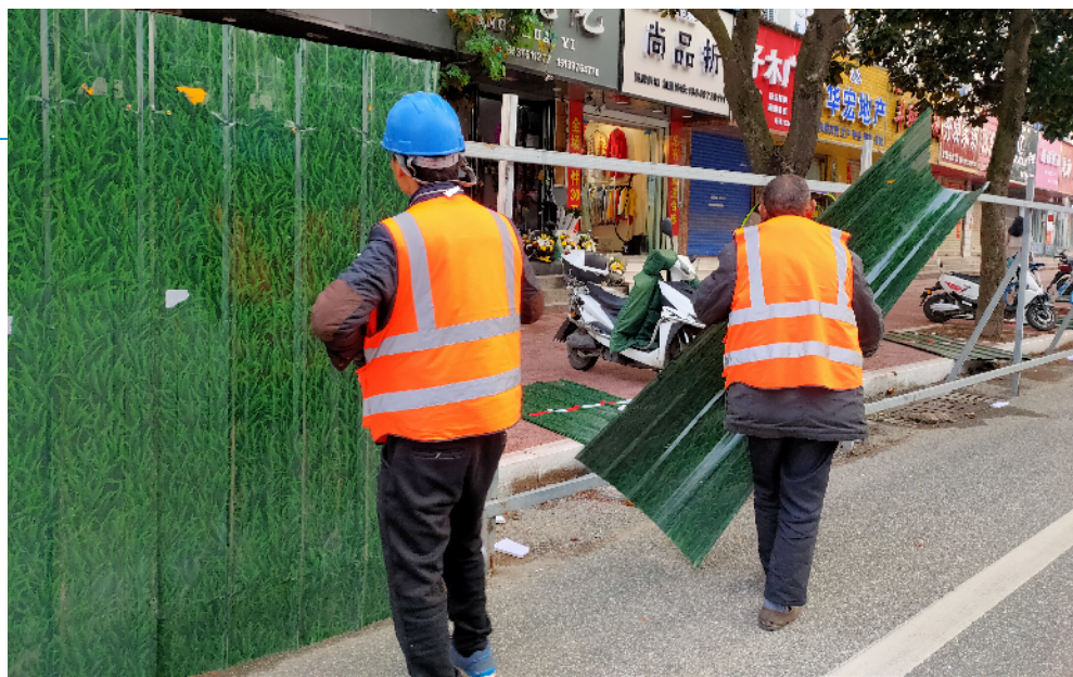
3月30日上午,两名工人正在拆除东方红大道西关段路北围挡。此前,工人们将东方红大道西关段路南人行道进行了改造,将原来的地砖拆除,重新铺上透水性混凝土,并喷上红色油漆和灰色油漆,用于区分人行道不同区域的道路功能。改造后的人行道人车分流更加清晰明显,也使得整个城市景观形象扮靓很多。 本报记者 张方志 摄
