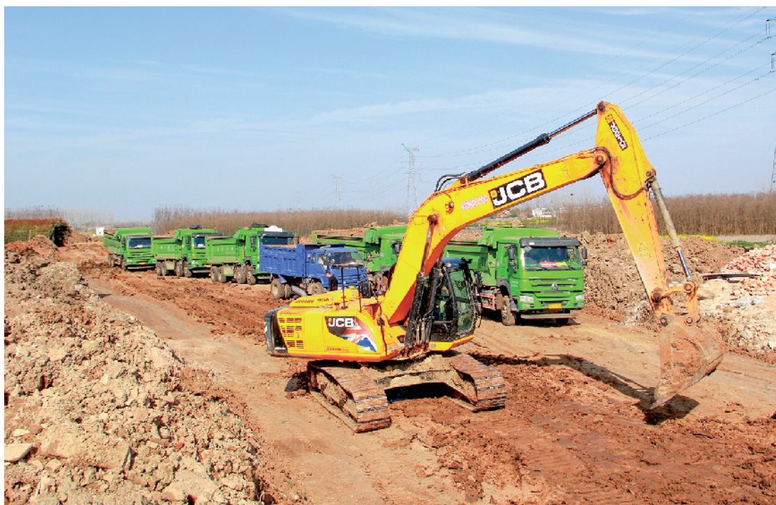
近期以来,潢川县按下复工复产“加速键”,加快重点工程施工进程。图为该县312国道改道施工现场。张灏摄
