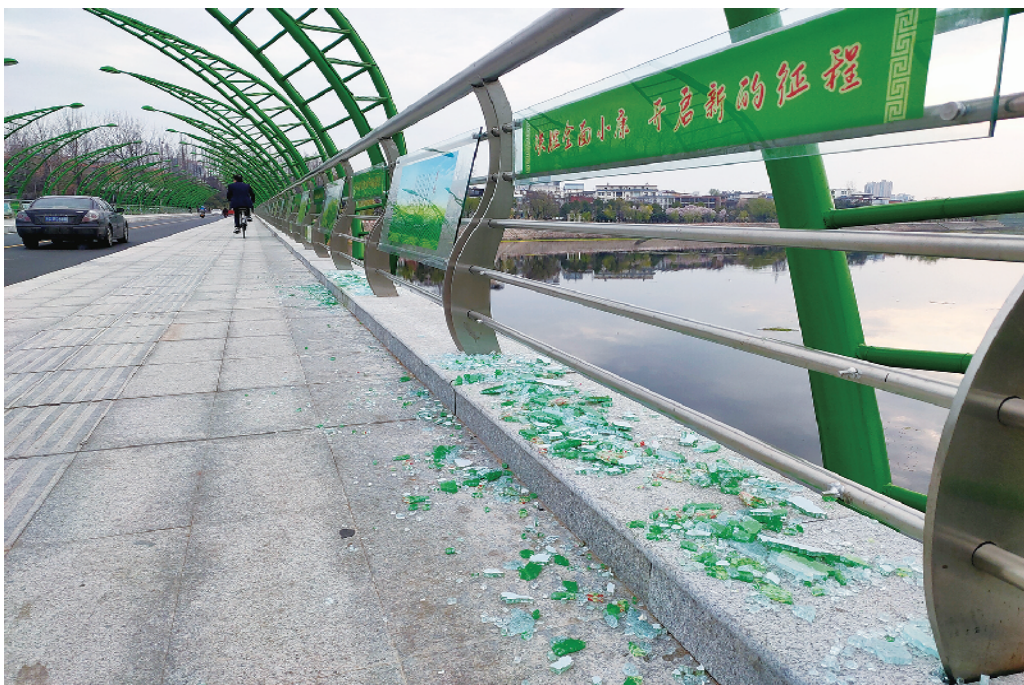
图为肖家河桥上破碎的装饰玻璃。 本报记者 张方志 摄
