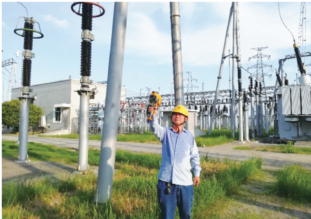
8月6日,信阳供电公司220千伏曹湾运维班运维人员头顶烈日,对变电站设备开展检查,确保辖区电力可靠供应。这是连日高温大负荷时段,该班进行的第七十次巡视检查。
