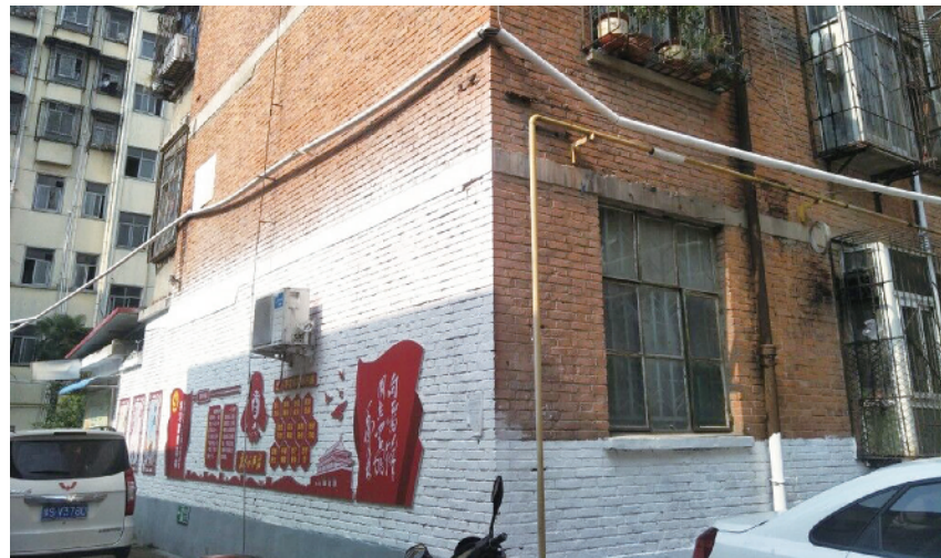
浉河区工信局家属院院内电线穿管 本报记者 吴楠 摄
