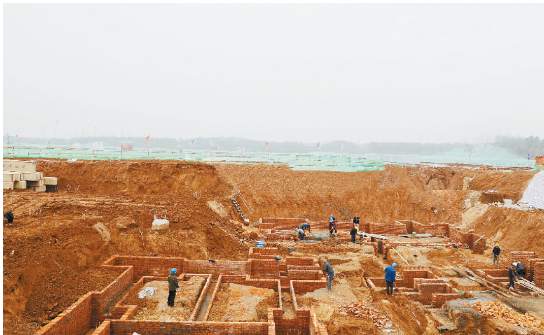
立冬已至,寒气逼人。昨日,记者在高新区明阳风电项目现场,看到的依然是一派热火朝天的施工景象。据了解,该项目主机装配车间区域201根机器钻孔灌注桩、办公楼区域101根人工挖孔灌注桩全部浇筑完成,正在清理施工区域内积土,下一步进行承台和地梁施工,预计2019年3月中旬建成。叶片生产车间工程正在进行工程招标,预计2019年5月份建成。 本报记者 邹乐 摄
