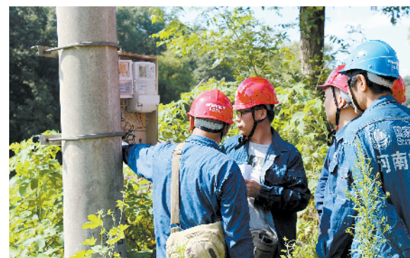
金牛山和孝营村一变压器存在用电异常,工作人员正在排查。 本报记者 李亚云 摄
