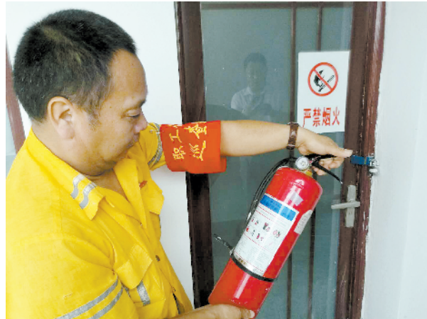
近期,信阳工务段开展了暑期消防安全大检查活动,对易发生火灾的地方逐个排查,确保安全度夏。图为职工代表对机修车间的消防器材进行检查。 吴宪宏 摄
