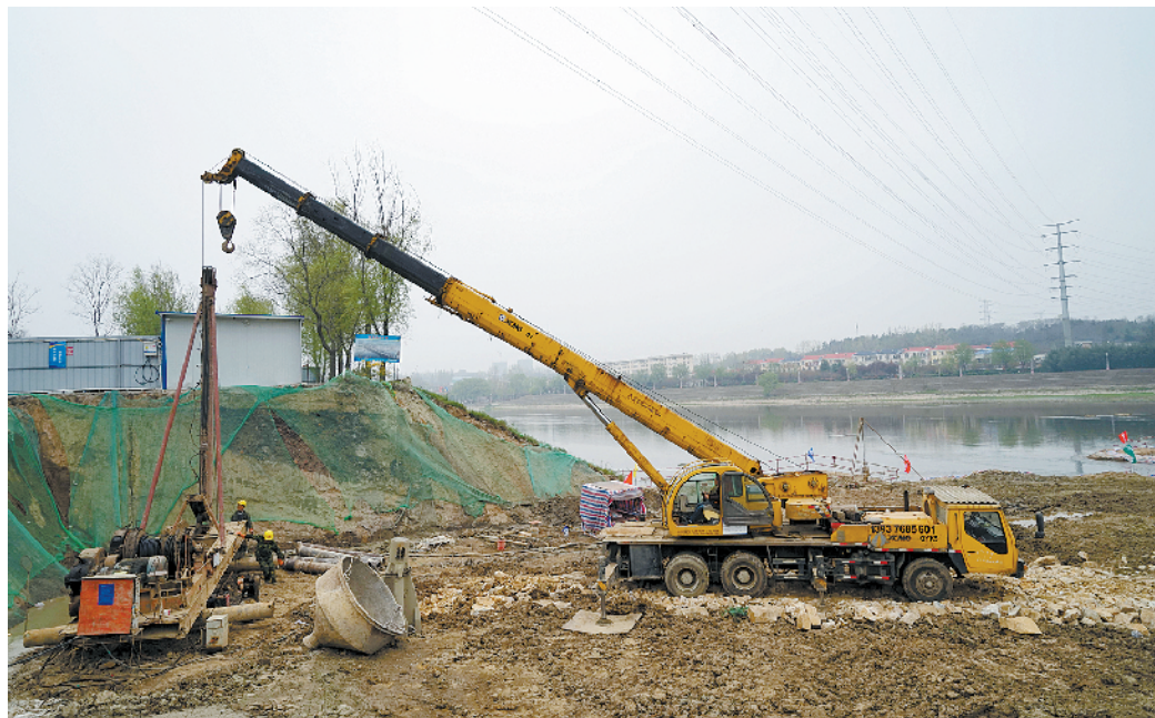
肖家河跨河桥市政工程施工现场,工人们正在进行桩基施工。本报记者 张镇 摄
