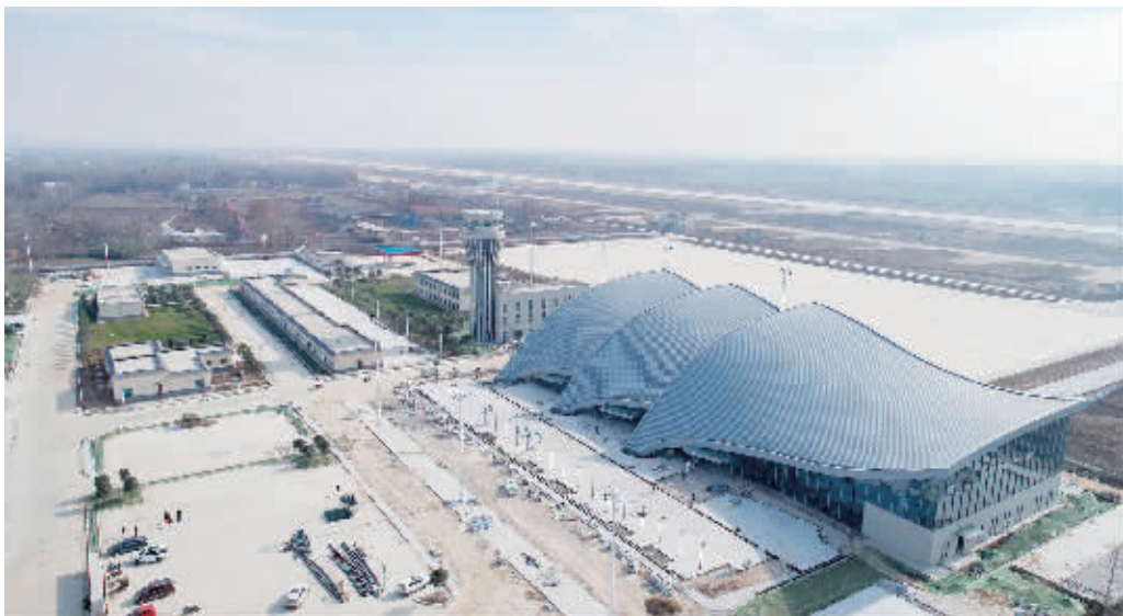
昨日,记者在明港机场施工现场看到,工人们正在加紧对航站楼、塔台等区域进行装修和设备安装,宽阔的飞行跑道正在画线。市民航局负责人介绍说,机场内航站楼和航管楼及塔台等主体工程已经完工,各项运营筹备工作全面展开,已招聘并培训一批一线生产人员。 本报记者 郝光 王哲 摄
