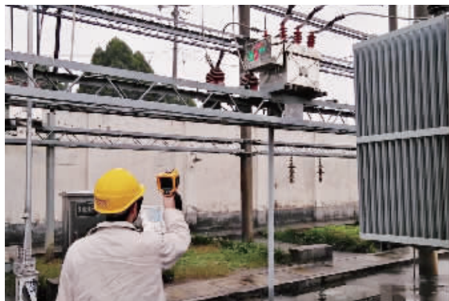
17日,为了确保电力稳定供应,信阳供电公司组织运维人员对35千伏胡店变电站开展特巡。 方非 高喜 摄
