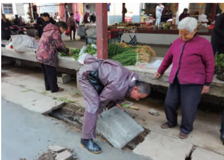
近日,为提升居民生活质量,改善居民居住环境,浉河区五星办事处红星社区积极行动,对辖区谭山包农贸市场进行三防设施集中整治,对自卖区破损地面进行硬化改造。图为办事处对破损的下水道井盖进行更换。本报记者 郭晓雨 摄
