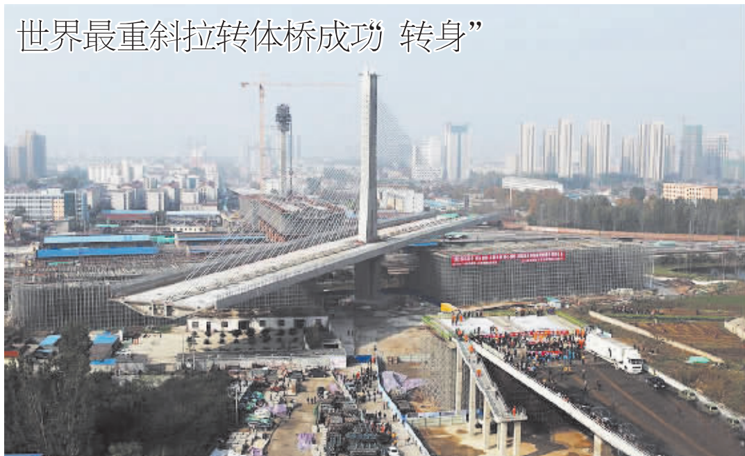
11月8日,在两台350吨连续式千斤顶的牵引下,自重达2.48万吨的山东菏泽丹阳路立交桥东侧主桥逆时针转动81.67度,与引桥实现精准对接。至此,当今世界转体重量最大的斜拉桥成功“转身”。 新华社发 刘心中 摄
