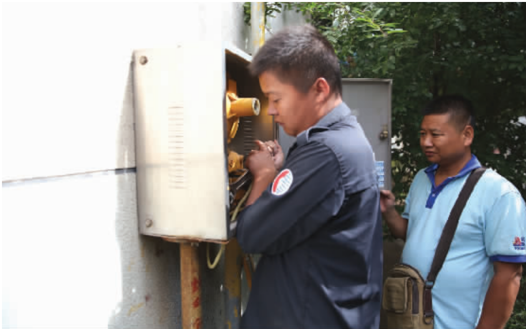
陈超正在更换压力表。郭晓雨 摄
