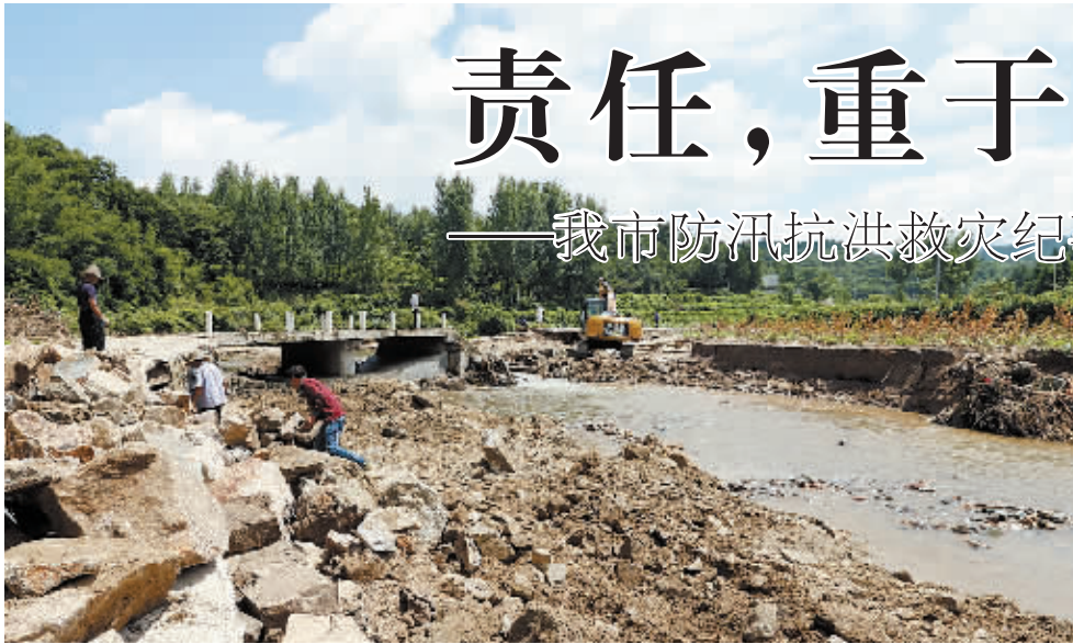
新县酒店乡的道路桥梁被洪水冲毁,干部群众冒着高温酷暑抓紧进行修复抢通。
