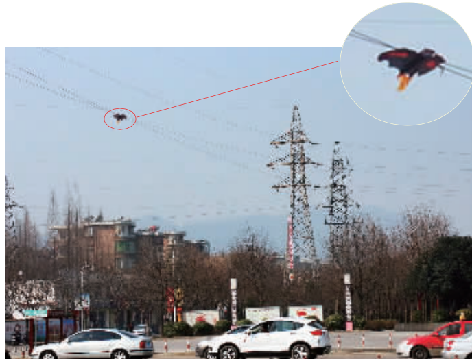
天伦广场南侧高压线上缠挂着断线的风筝
