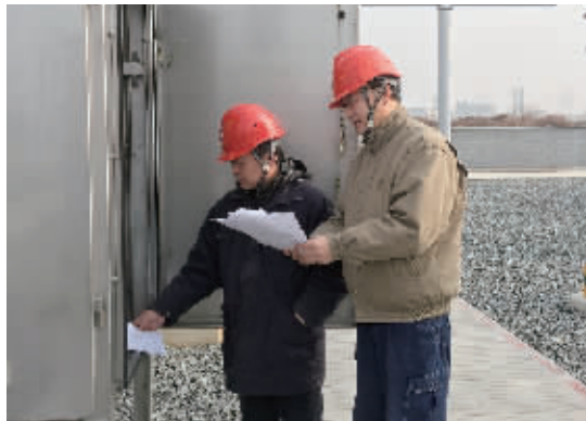
1月11日,笔者获悉,固始新投运220千伏漳圣变运行平稳。该站是固始第一座智能变电站,于2015年12月30日一次送电成功。该站的成功试运,有效地缓解了固始县经济高速发展过程中备用电力不足的问题。图为信阳供电公司运行人员正在检查漳圣变设备情况时的情景。 方菲 吴俊芳 摄
