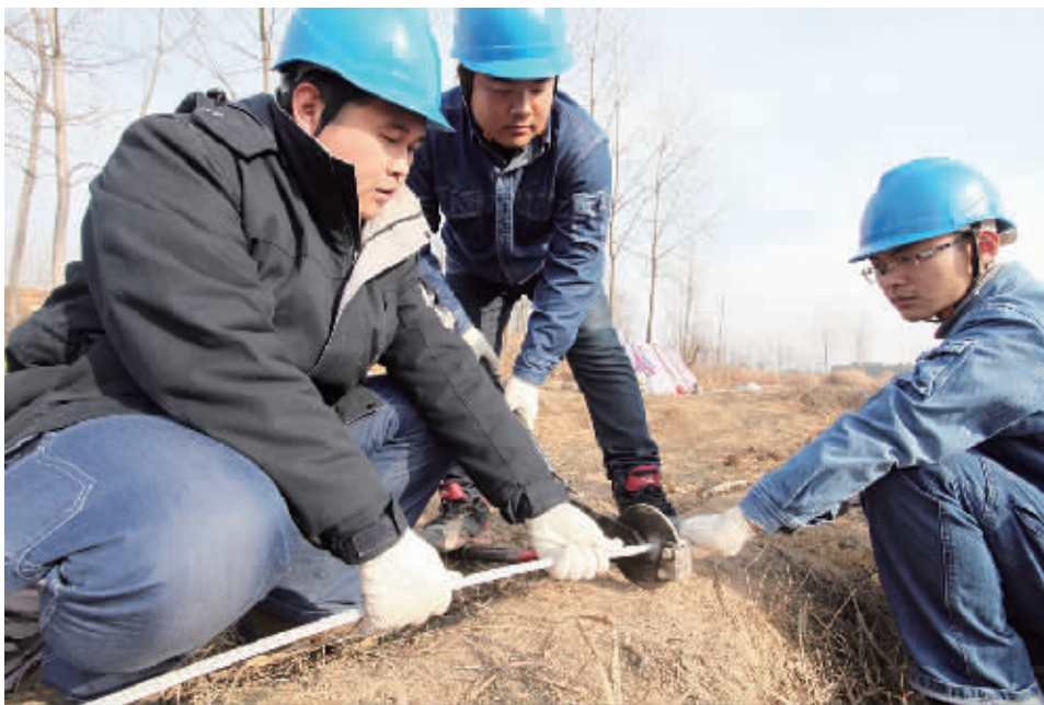
元旦期间,信阳供电员工放弃假期,仍然坚守在固始220千伏漳圣变电站配出工程现场,抢天夺时加快工程进度,力争尽快完工投运,为冬季用电大负荷和春节高峰用电做好准备。 杨君 摄
