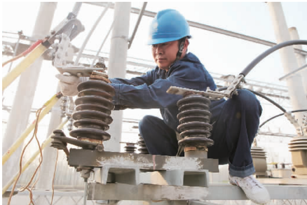
昨日,淮滨县供电公司对该县35千伏三空桥变电站设备进行全面“体检”,消除缺陷。据悉,此次“体检”包括对老旧断路器、隔离开关、保护装置和设备线夹的更换,以及为传动机构添加润滑油、紧固连接螺栓等,确保电网安全越冬。
