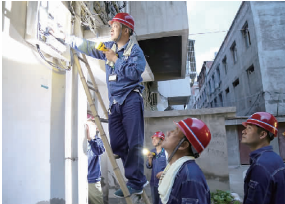
近日,固始县供电公司开展了夏季用电安全检查及营业稽查专项行动,共查获窃电4起,表计信息错误28起,消除安全隐患12处。据悉,此次专项行动是对城区商业密集区的客户安全用电、计量装置运行情况、电价执行情况进行现场检查,进一步规范供用电秩序,消除安全隐患,确保用电安全。 高伟 李松 摄
