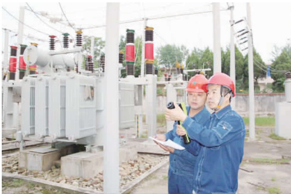
入伏以来,光山县供电公司积极组织员工,对公司所辖的变电站设备开展红外测温巡视工作,做到隐患早发现、早排除,为电网迎峰度夏保驾护航。图为近日,该公司变电运维人员手持红外线测温仪在35千伏仙居变电站对运行中的设备进行测温。
