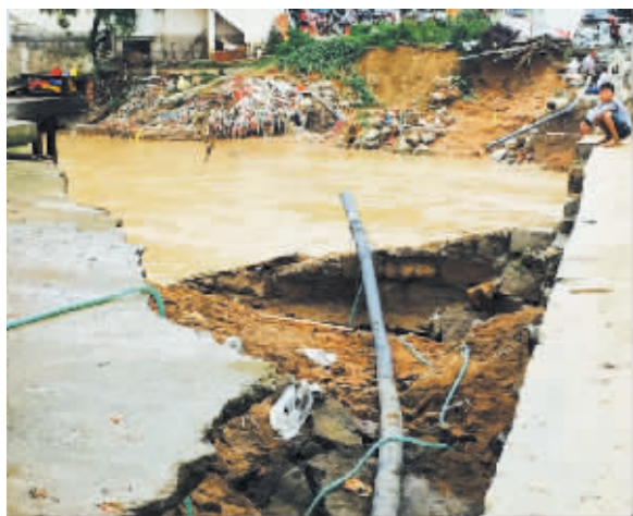
商城县伏山乡路面损毁严重 网友@“奋韩笔记”摄
