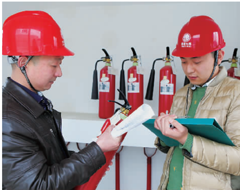
3月21日,淮滨县供电公司春检检查人员对所有13个变电站内安全工器具、供电设备以及消防器材等设备安全状况进行督查,针对重复出现的不安全问题,深挖隐患背后的制度缺陷和管理漏洞,全方位排查消除各种不安全因素。 吕玲 摄
