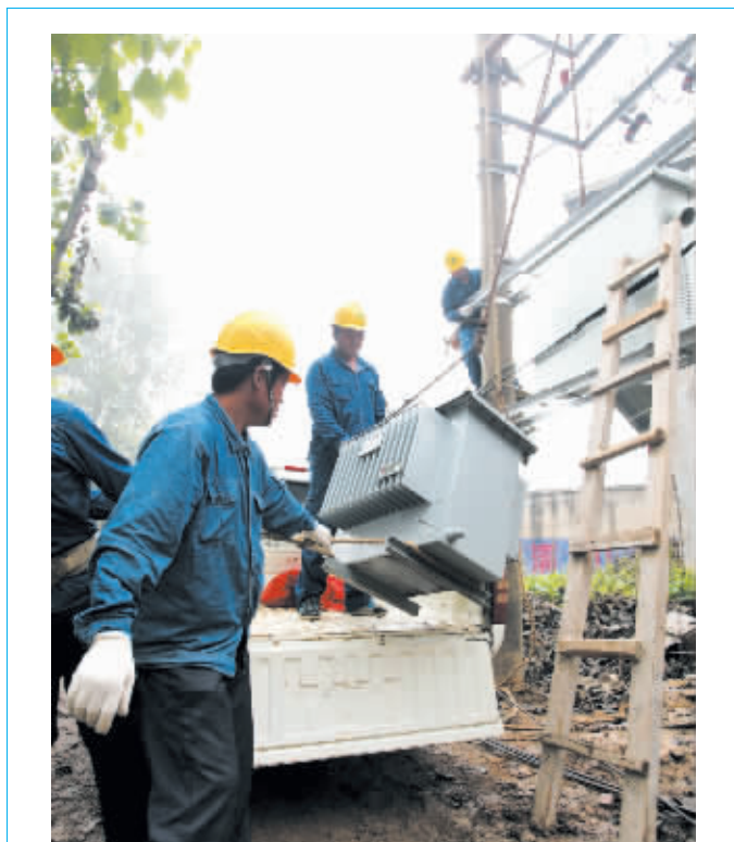
11月25日,潢川县电业局组织来龙供电所为刘大营村新建一台容量为100千伏安的变压器,切实解决该村100余户用户的低电压问题。图为施工人员进行变压器安装工作。杨君 摄
