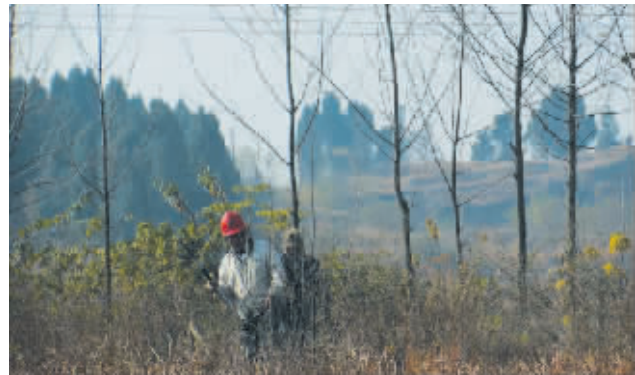
每年的冬季用电高峰到来之际,光山县电业局以提高输电线路消缺率为抓手,加大对运行年限较长输电架空线路的特巡、特维力度,杜绝发生电网安全事故,为电网的安全稳定运行保驾护航,为地方经济社会快速发展提供充足、稳定的电力供应。图为11月24日,该局输配电部员工正在110千伏松光线路下方清理树障。张磊 屈伟 摄
