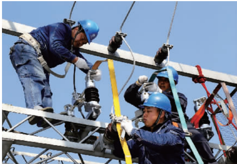
11月18日,固始县电业局对柳树35千伏变电站12组10千伏隔离开关进行更换,提高设备健康水平,为即将来临的冬季用电高峰做好准备。高伟 摄
