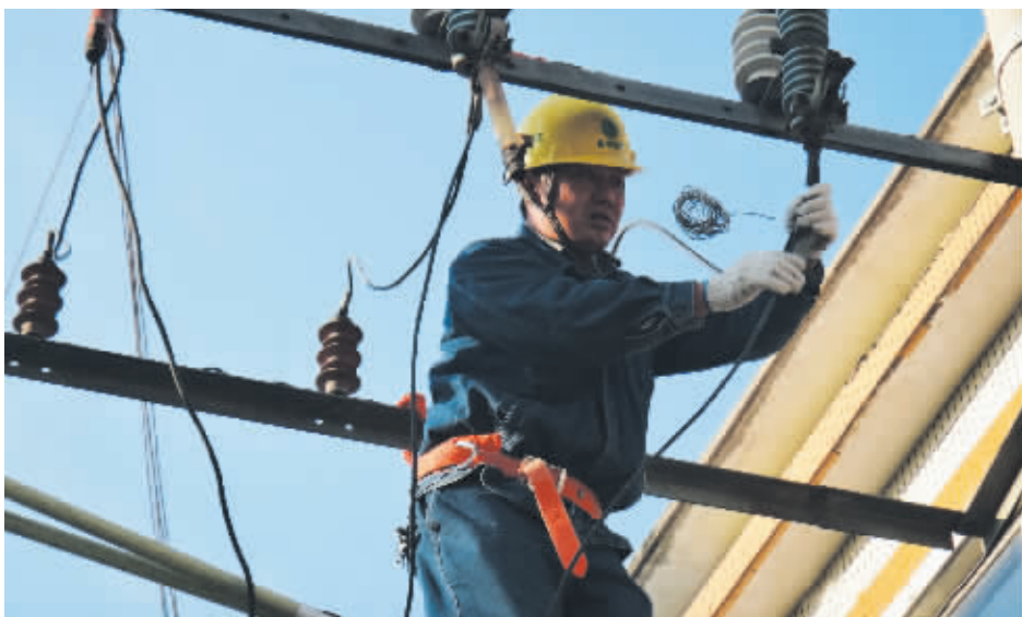
10月29日,淮滨县电业局北城供电所对315千伏安河变进行秋检,有序开展配电设备隐患排查工作,确保电网设备安全越冬。 陈建侠 摄
