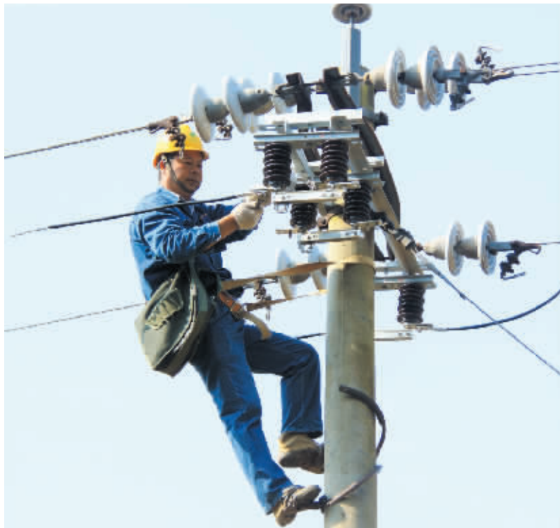
10月16日,潢川县电业利用110千伏付店变电站停电施工时机,抽调20余名精兵强将,分成5个班组同时对线路进行改造升级,有效避免重复停电给客户带来的影响,切实提高供电可靠性。图为,该局员工正在为10千伏付店5线林南分支线路进行加装隔离开关改造。 李昊益 摄
