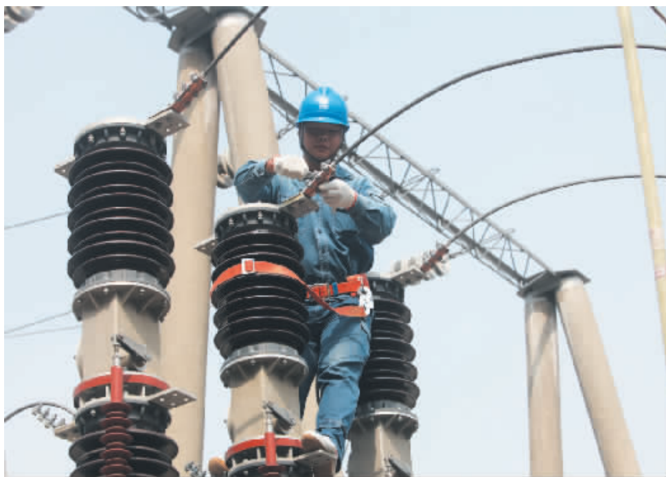
为持续提升供电可靠性和供电服务质量,淮滨县电业局利用秋季负荷较轻的有利时机,对供电设备进行了一次全面彻底的隐患排查,集中消除隐患。图为10月8日,该局员工对110千伏淮滨变电设备进行消缺。陈建侠 摄
