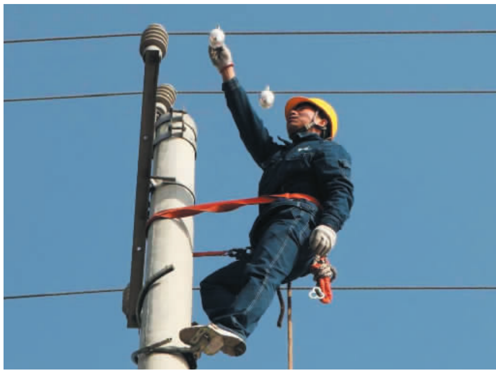
为有效降低配网故障率,淮滨县电业局利用秋季配网负荷较轻的有利时机,对配电线路、设备和台区进行一次全面排查,集中消除设备缺陷,持续提升供电可靠性和供电服务质量。图为9月18日,该局员工对10千伏淮丝线加装驱鸟器和故障指示仪,确保线路正常运行。 陈建侠 摄
