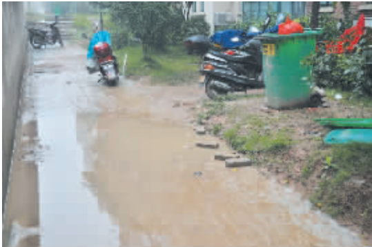
铂金丽都6号楼单元门洞前的路面被水淹,居民出入需踩砖。
