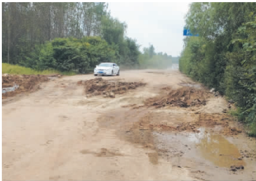
近日,记者在S224平桥区洋河至龙井段发现有一段公路毁坏严重。据经常过往的司机介绍,由于路况太差,常有车辆在此发生翻车事故,但并没有引起交通部门的重视,过往司机都很烦恼。在此,本报提醒相关部门及时修复毁坏的公路,避免交通事故再次发生。 见习记者 付宇峰 摄
