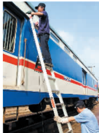
为了确保特种车辆安全,武昌客车车辆段信阳运用车间对配属行李车设施进行了全面检查,图为7月16日,该车间职工正在维修行李车大拉门防雨沿时的情景。 方昉 摄
