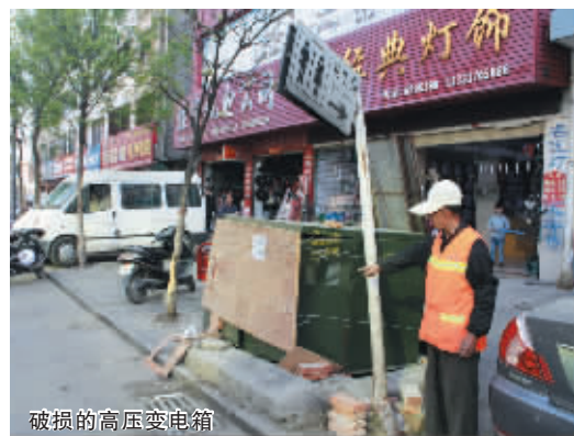
破损的高压变电箱
