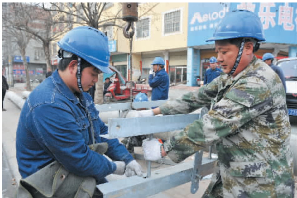
3月20日,固始电业局对城区全长3.65千米的淮河路10千伏供电线路进行升级改造,通过拆除老线路,使用绝缘导线,增加导线半径,增加供电台区等措施,进一步满足城区用电负荷增长需求。 高伟摄
