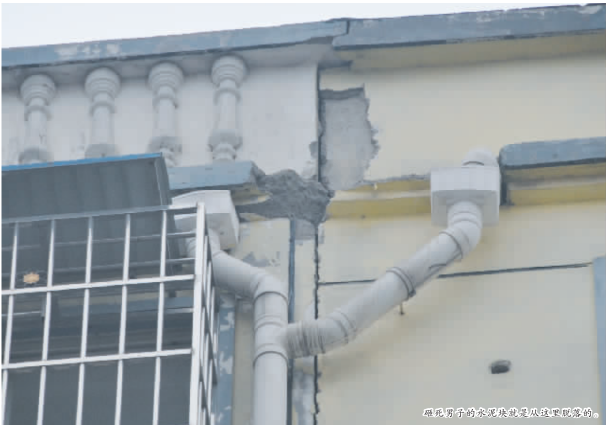
两楼交界处的另一个点,裂缝明显,水泥块松动。
