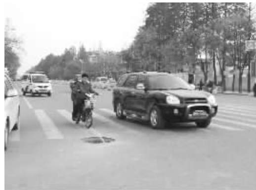
本报曾于11月26日在A4版报道工区路信阳双龙食品公司门前马路中间一处窞井盖严重受损,给过往车辆行人带来安全隐患。昨日,又有市民打电话向本报记者反映,该处窞井盖已经损坏半个多月了,但至今仍未修复,希望相关部门早日修好破损的窞井盖,方便市民出行。 本报记者 吴楠 摄
