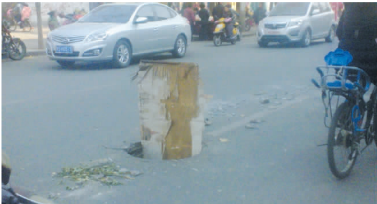
昨日上午,市民陈先生向本报反映称,新华西路市供销社于校门前一个下水道的窨井盖缺失,已经有好几天了,但一直没人更换。据附近居民介绍,少了盖子的窨井“张着大嘴”时刻威胁着过往车辆和行人。为了提醒车辆和行人注意安全,有人在没盖的窨井里竖起了一块木板(如图)。本报希望相关单位及时为这个窨井加上安全盖。 本报记者 张方志 摄
